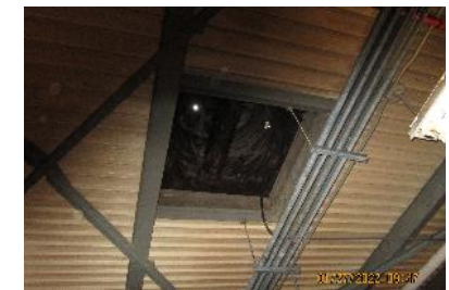
C-635-3 - Exhaust Fan Opening
